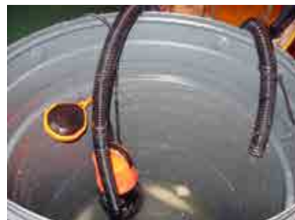
Anläggningen sedd ovanifrån.
